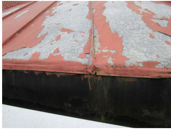
Kuva 26. Peltikattoisen osan vesikaton maalipinnoite irtoilee laajasti. (Julkisivun kuntotutkimus 17.10.2016, Raksystems Insinööritoimisto)
